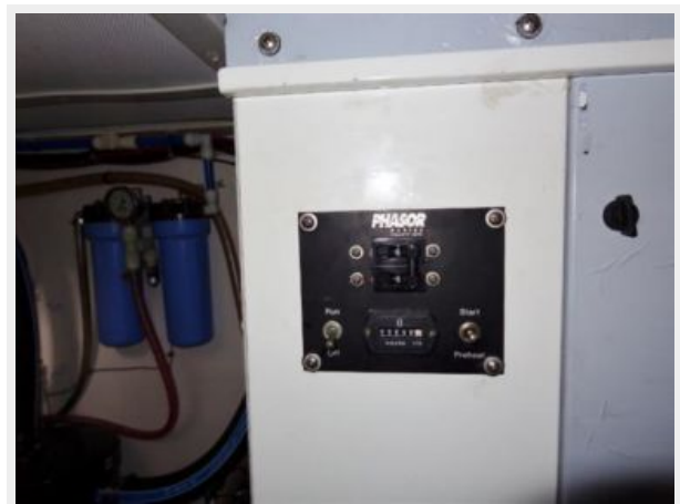
Generator Hour Meter
