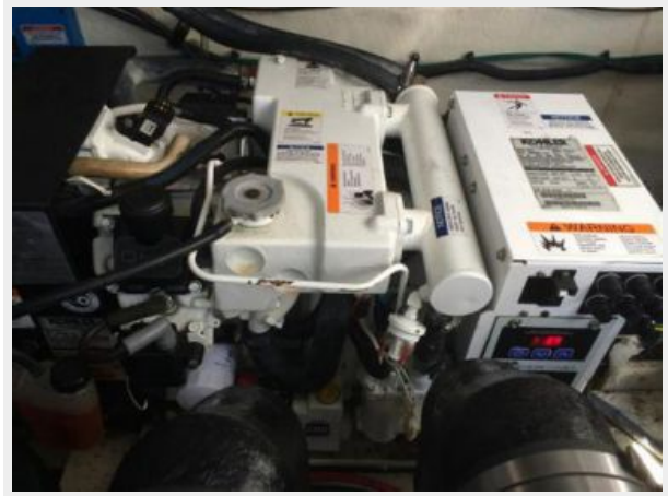
Kohler 5 kW Generator
