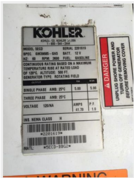
Kohler 5 kW Generator
