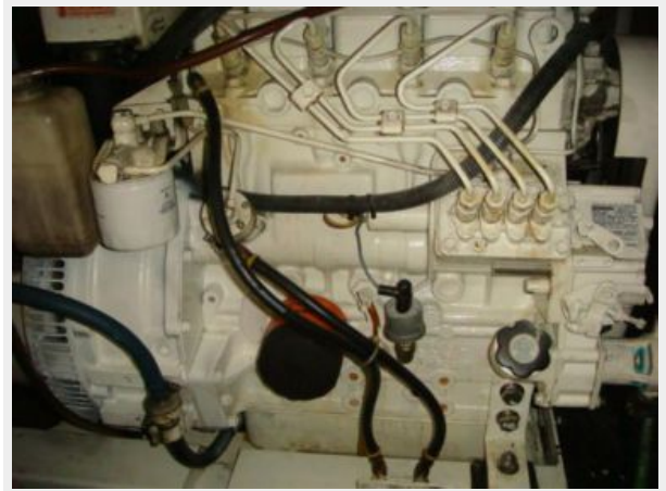
64' Hatteras port generator
