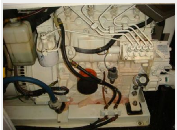
64' Hatteras port generator
