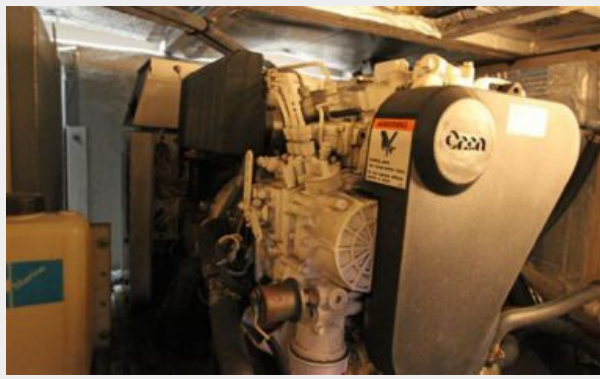
Onan 9kw Generator
