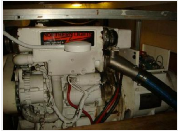
42' Kadey Krogen generator
