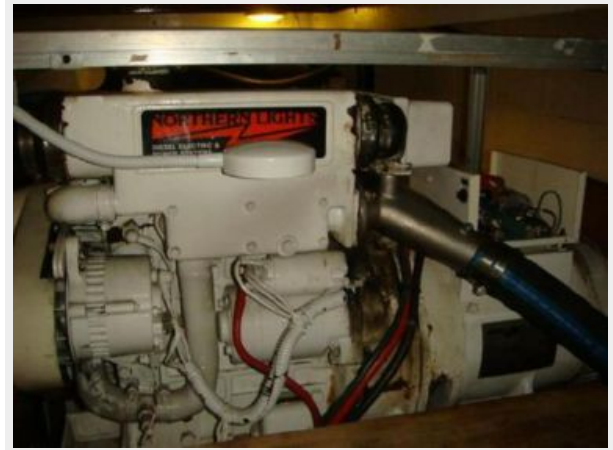
42' Kadey Krogen generator
