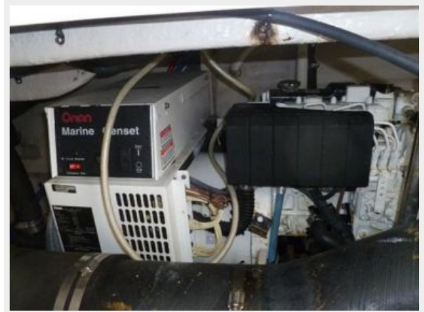
Onan 9KW Generator
