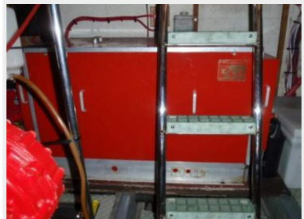
Westerbeke 8kW Generator
