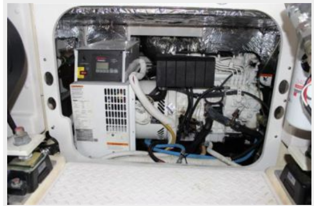
Onan 11.5KW generator
