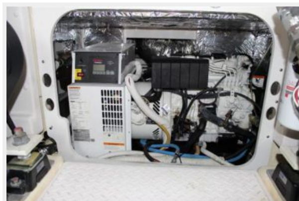
Onan 11.5KW generator
