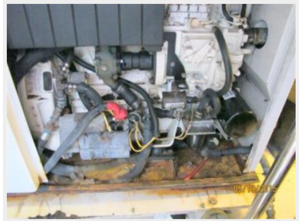
13.5kW Onan Generator
