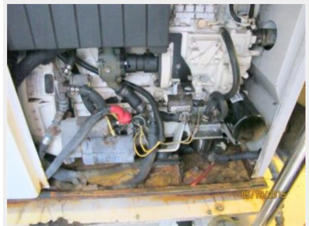
13.5kW Onan Generator
