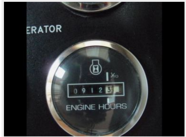
Generator Hour Meter
