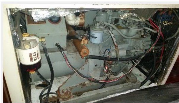
Universal 6.5KW Genset (306 hrs.)
