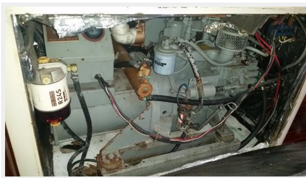
Universal 6.5KW Genset (306 hrs.)
