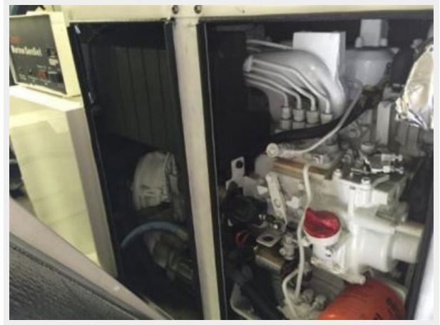
Stbd Generator III
