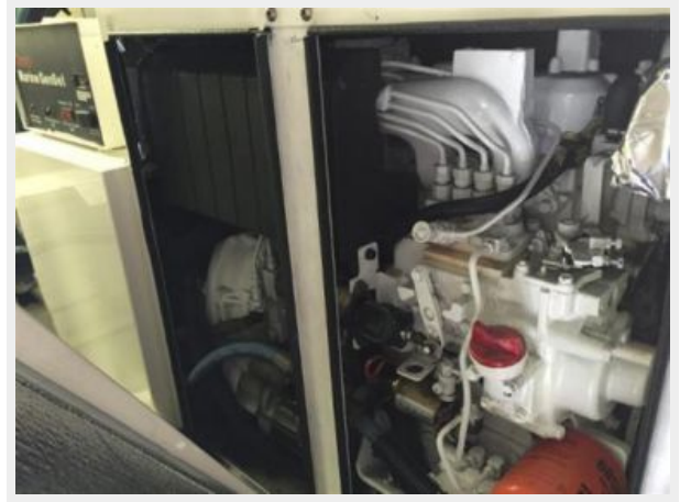
Stbd Generator III
