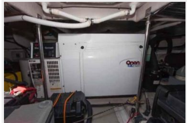
Onan 21kw Generator
