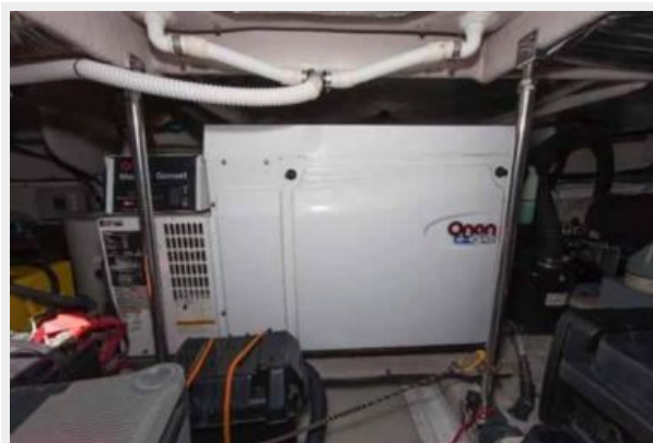
Onan 21kw Generator
