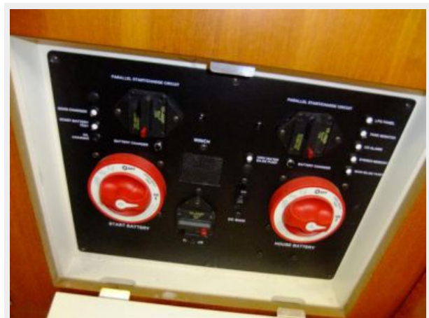
Hunter 41 DS Electrical Panel
