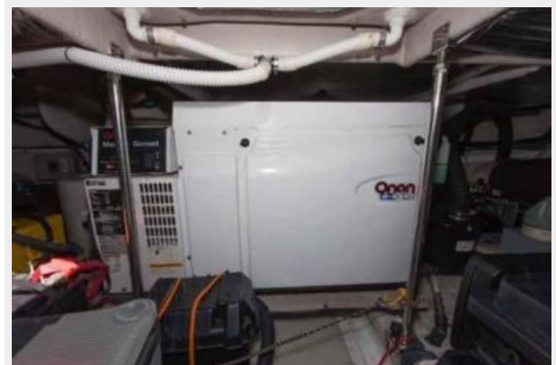
Onan 21kw Generator
