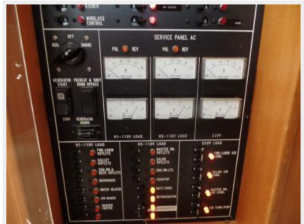
Breaker panel (2).JPG
