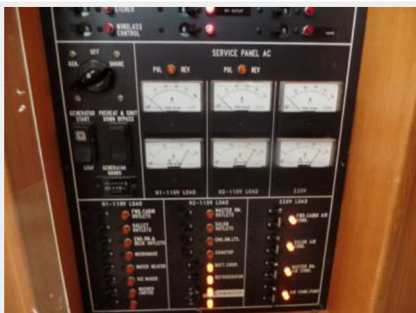
Breaker panel (2).JPG
