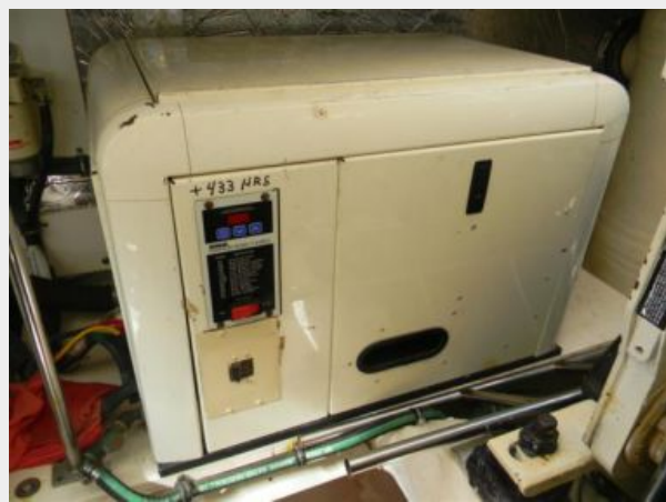
Kohler 8KW generator
