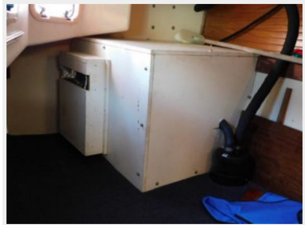
43 42&apos Catalina generator
