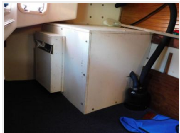
43 42&apos Catalina generator
