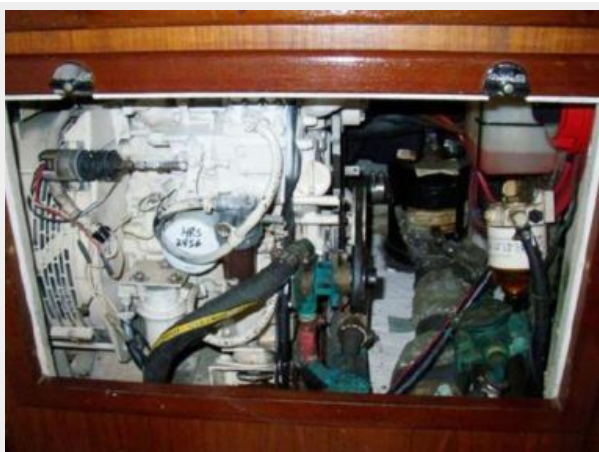
Kohler 5kW Diesel Generator_2460 hrs
