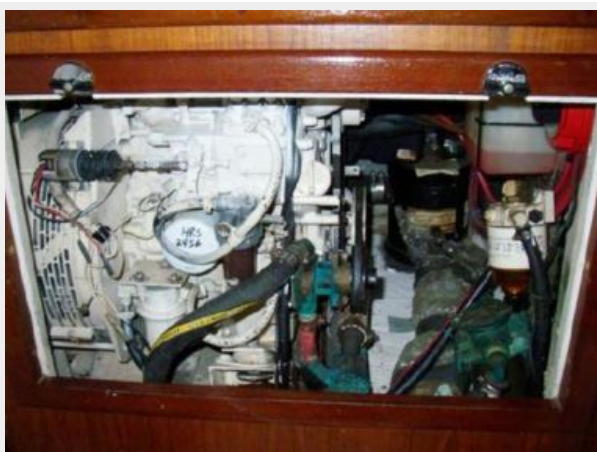
Kohler 5kW Diesel Generator_2460 hrs
