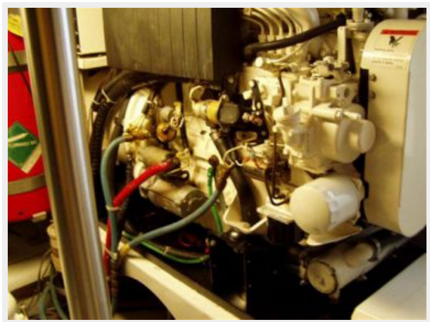
25kW Onan Generators (2)
