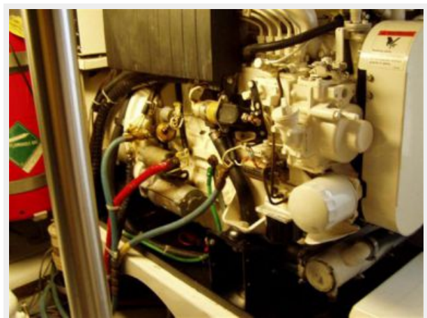
25kW Onan Generators (2)
