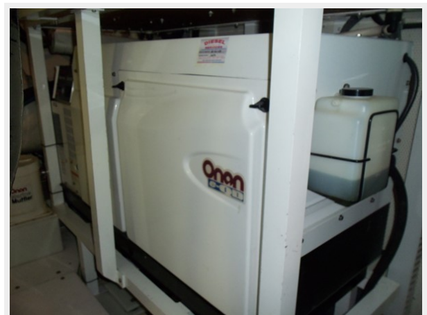
Starboard 27 KW Gen
