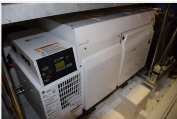
32kW Onan gensets
