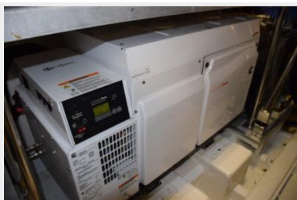
32kW Onan gensets
