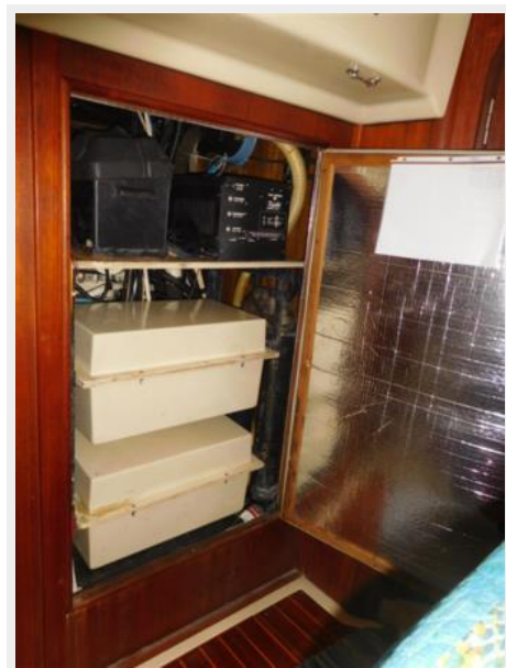
EL LIBRE BATTERY LOCKER 1
