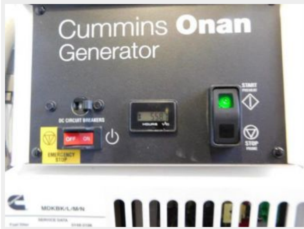
Generator Hour Meter
