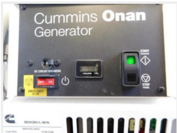
Generator Hour Meter
