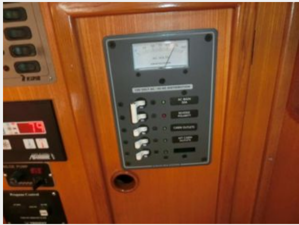
25) AC Main Panel
