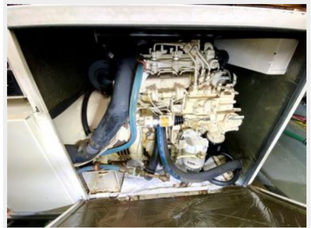
Onan 8KW generator
