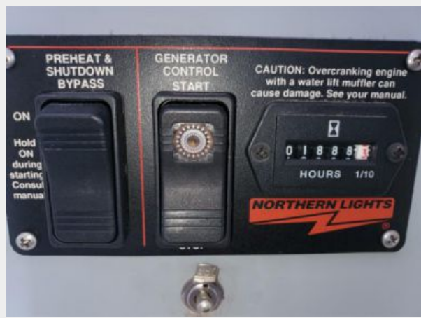
Generator hour meter
