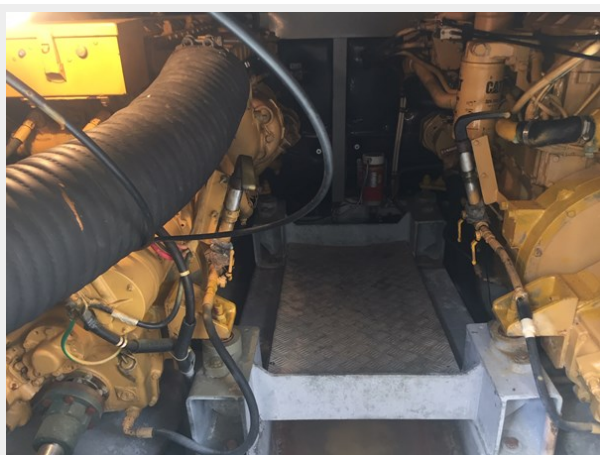
Azimut 36 Fly - Motor Yacht - interior - Motores - IMG_1696
