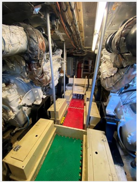
301 ER Aft to Fwd
