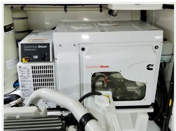
36. 17kW Onan Generator
