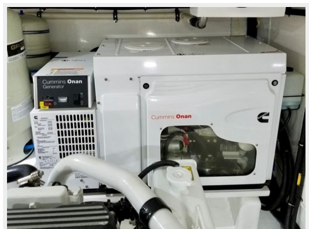
36. 17kW Onan Generator
