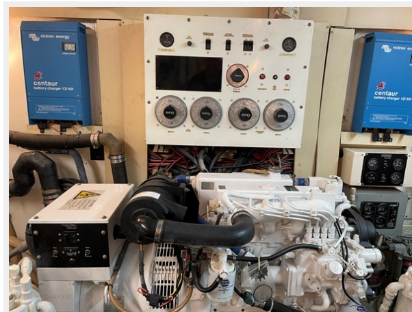
48. 20KW Phaser Generator
