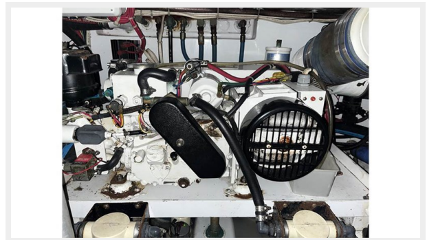
Next Gen 5kW Generator
