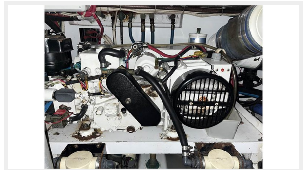
Next Gen 5kW Generator
