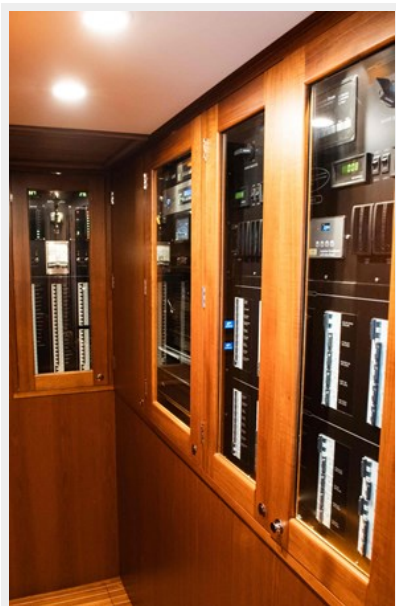
Electrical/ AV Room
