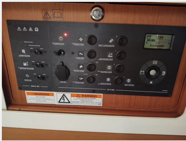
Hendaj electrical panel
