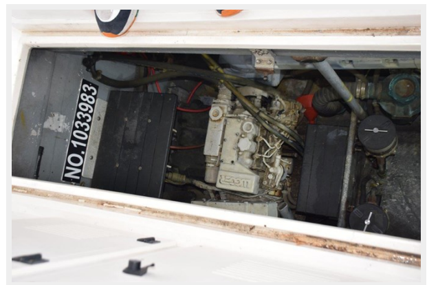
N. Lights Generator Aft, Center Hatch
