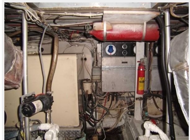
Onan 7.5KW Generator
