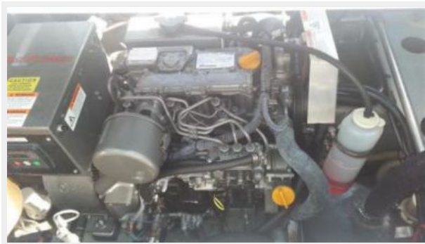
Yanmar 9KW Genset (430 Hrs.)
